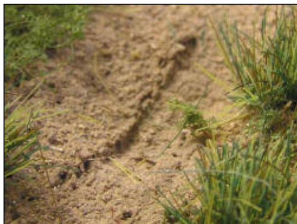
Obr.4 – Detail výmolu v cestě
